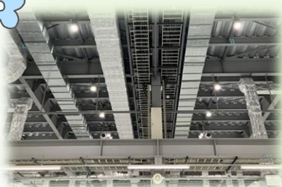
▲ケーブルラック天井の様子
