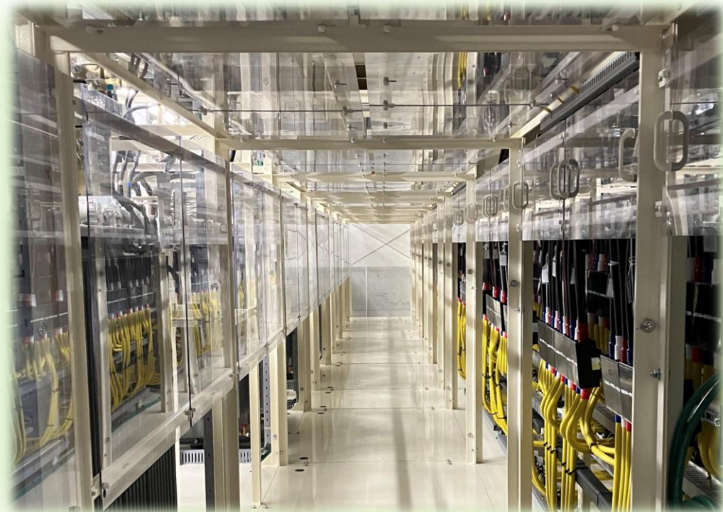
▲キュービクル式オープン型はメンテナンスを徹底的に考慮された電気室です
