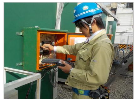
▲仮設盤の点検中です
