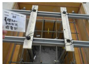
▲ 避雷針アンカー状況
