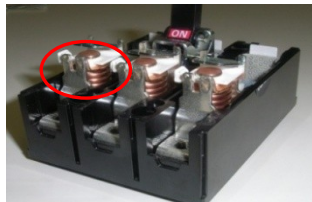
ブレーカーのカバーを外した状態
