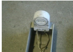
▲劣化が進んだソケット
