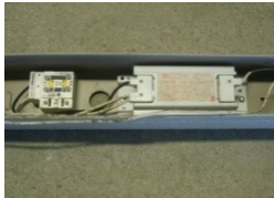
▲劣化が進んだ安定器
